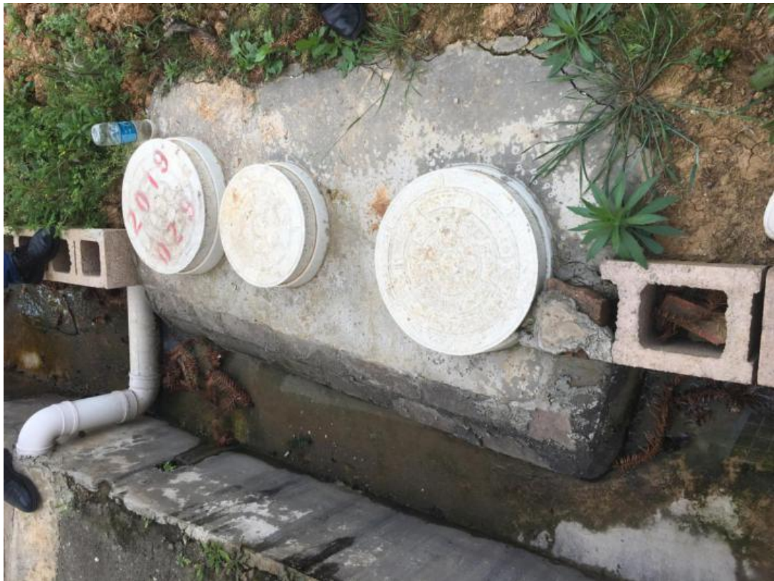
图 3-4 三格化粪池现场图
